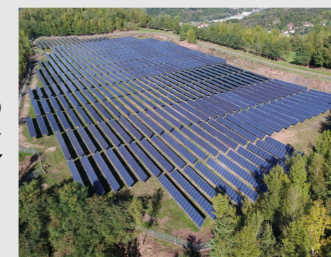
Centrale Solaire de DECAZEVILLE Département de l'Aveyron (12) Puissance électrique : 11 400 kWc Mise en service : 2017
